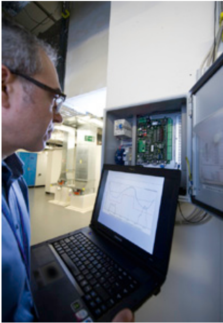
Abbildung 1: Inbetriebnahme des zentralen Datenerfassungsmoduls in der Lüftungszentrale
