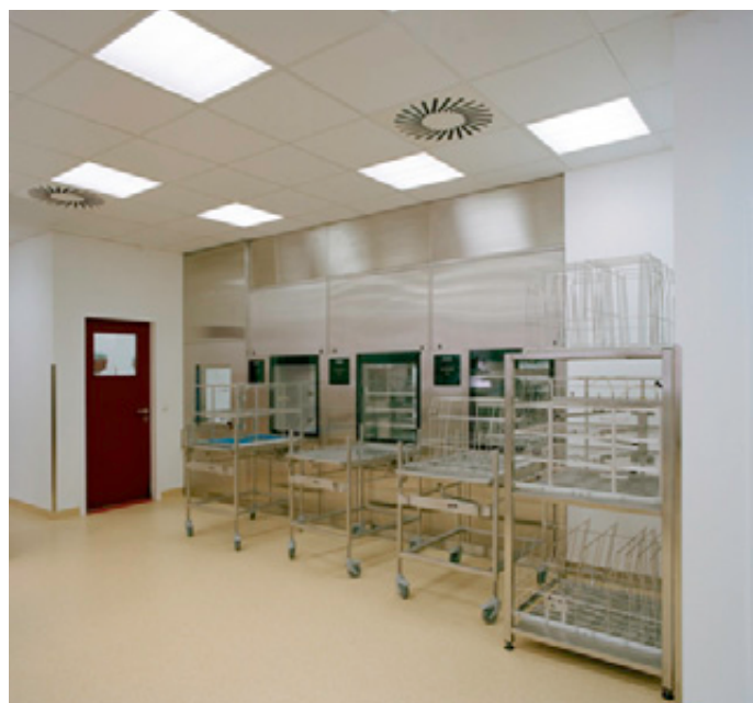
Entnahmeseite Reinigungs- und Desinfektionsgerät (HWP Planungsgesellschaft mbH, Fotograf: Peter Horn)
