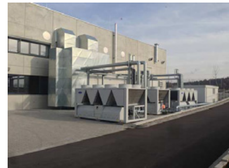
Zentrale RLT Anlage mit 45.000 m 3 /h, Kälteaggregate mit 1,3 MW und Trafo-Station
