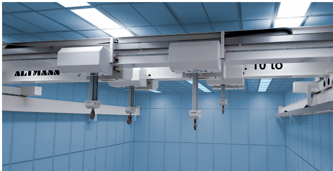
2 Einträger-Laufkrane mit je 2 x 8 t Hubwerken – beide Krane und alle vier Hubwerke synchronisiert in allen Fahrachsen mit einer Präzision von +/- 1 mm
