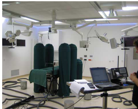
Robert-Bosch-Krankenhaus Stuttgart (OP Raumklasse Ia mit Deckenluftmodulen - Abnahmesituation nach Anhang C „Schutzgradmessung“ DIN 1946-4:2008-12) (Bildrechte: MANN + HUMMEL)
