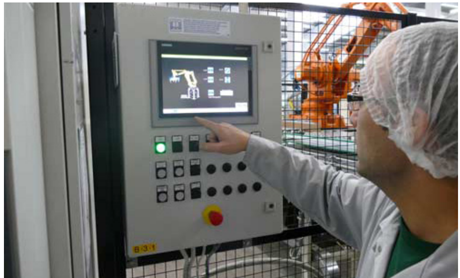
Steuerung der Safe Packs am Touchscreen.
