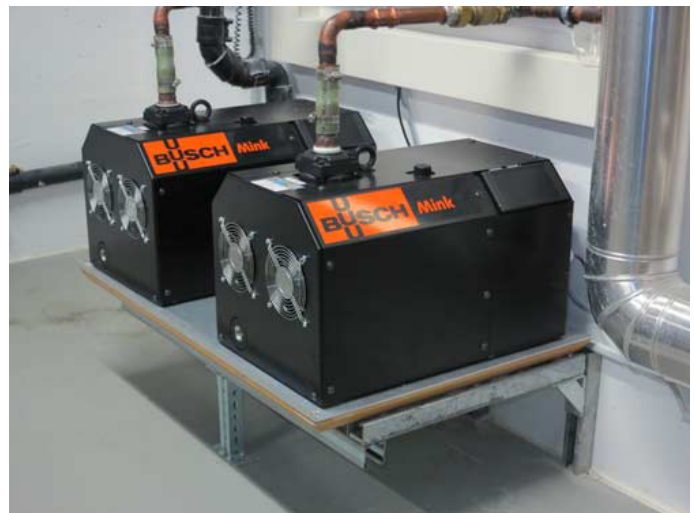
Fig. 1: Zwei redundante Mink MV Klauen-Vakuumpumpen von Busch im Technikraum des Laborzentrums.
