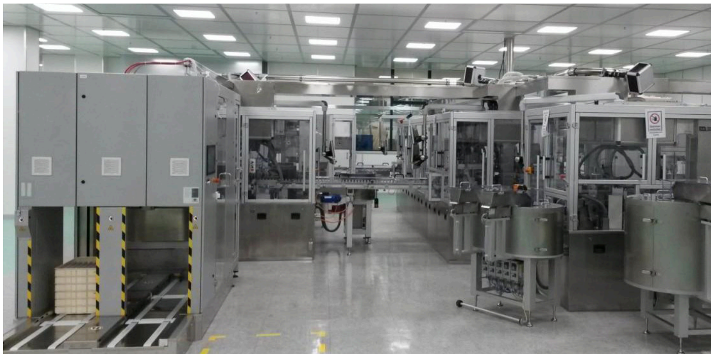
Die Halle 2 (Montagebereich) der Gerresheimer Regensburg GmbH in Pfreimd wurde mit leistungsfähigerer und energieeffizienterer Technologie ausgestattet.
