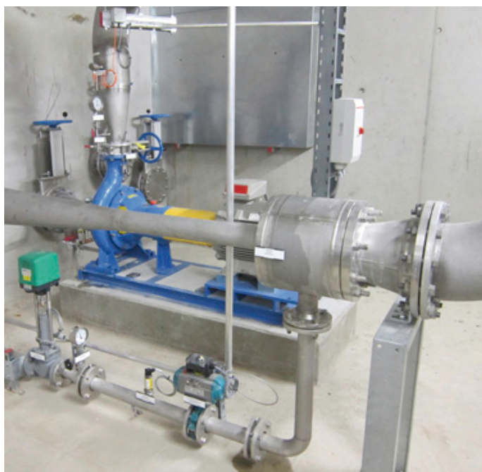
Einmischstrecke für das Ozon in einem großen Projekt der Papierindustrie, in dem HAGER + ELSÄSSER ihr neues AOP-Verfahren umgesetzt haben.
