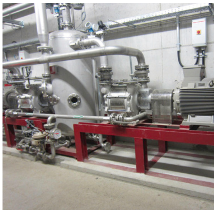
Vakuumpumpen und Ozonerzeugung in einem großen Projekt der Papierindustrie, in dem HAGER + ELSÄSSER ihr neues AOP-Verfahren umgesetzt haben.
