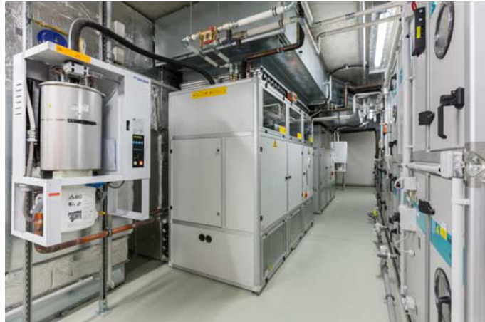
Abbildung 4 Weiss Klimatechnik: Die Klimazentrale mit Weiss Umluft-Klimakompaktgeräten, zentraler Außenluftaufbereitungsanlage sowie separatem Befeuchtersystem.
