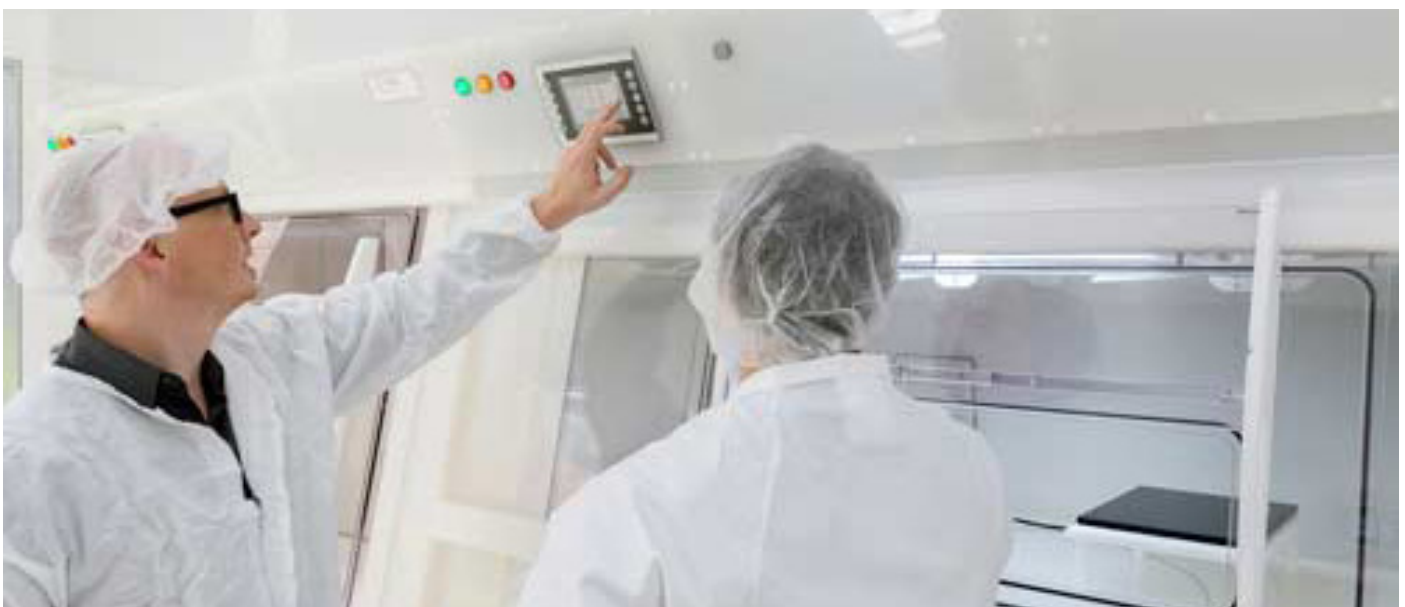
Über integrierte Touch-Displays wird die Lüftungs- und Versorgungstechnik an den Arbeitsplätzen individuell gesteuert.
