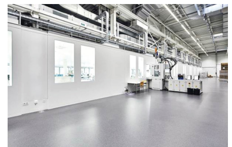
Bei der Planung des Reinraums musste bc-technology die Anforderung von Pajunk beachten, dass auch nachträglich noch Maschinen angehängt werden können, die zeitlich versetzt und unabhängig voneinander in Betrieb genommen werden sollen. (Quelle: bc-technology GmbH)
