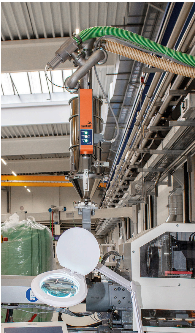
Die Entstaubungsmodule auf den Fördergeräten ermöglichen den Einsatz von Mahlgut ohne Qualitätseinbußen. Der anfallende Staub wird automatisch im zentralen Filter in einem separaten Raum abgeschieden. (Bild: motan-colortronic)
