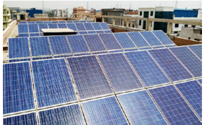
Die Solarmodule auf dem Dach von Triveni sorgen für umweltfreundlichen Strom.
