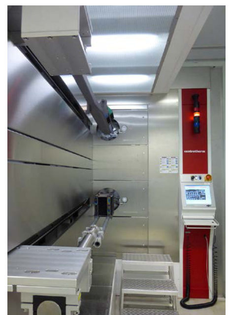
Für den Reinraum des Fraunhofer ISE hat das InES-Konsortium die Fernüberwachung der Zellen im Diffusionsrohr umgesetzt. (© Foto Fraunhofer ISE)
