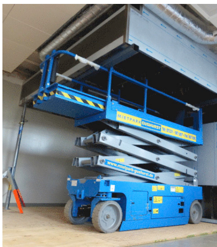
Aufbau der PTA Laminar-Flow Anlage innerhalb der Produktion. (Bild: CESRA)
