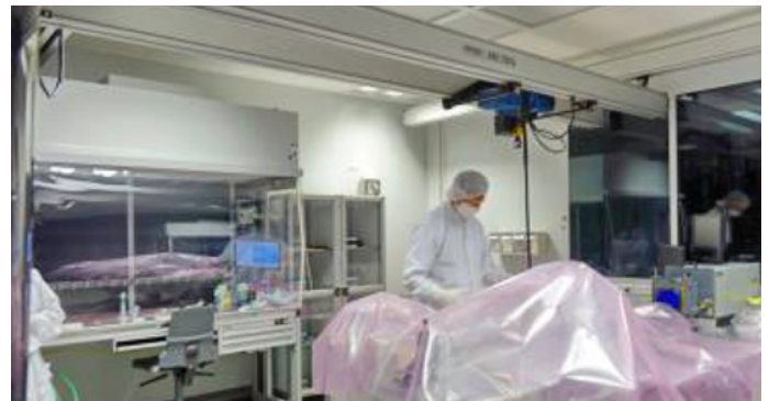
Nerling baute eine Hängekrananlage mit 250 kg Nutzlast ein, wobei zwei Stützen komplett hinter der Reinraumwand verborgen werden konnten. Die anderen beiden befinden sich hinter einer Stahlblechverkleidung in den Raumecken. (Quelle: Nerling Systemräume GmbH)
